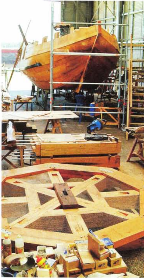
Vooraan de bodemplaat van de nieuw te bouwen lantaarn voor de torenspits van de OLV-kerk van Rupelmonde.
