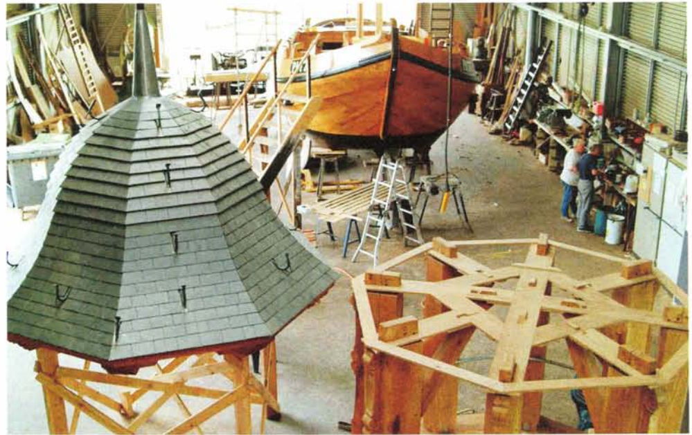
Schaliedekkers hebben de kap van de lantaarn met leien bedekt: een werkje voor specialisten.
