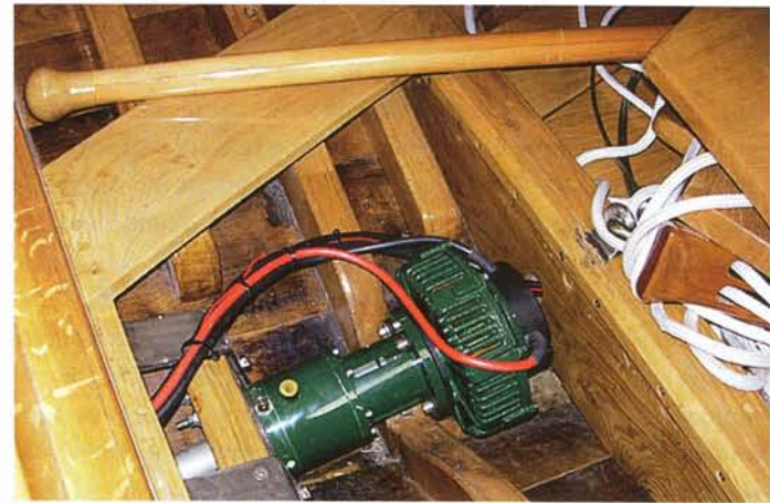
Een elektromotor wordt (bijna onzichtbaar) ingebouwd.
