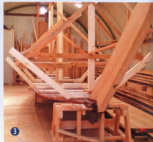
3 De voorsteven is met een uitwendige knie, die ook als scheg of loefbijter dienst doet, aan de middelste plank van het vlak bevestigd. De bouwmallen zijn opgesteld.
