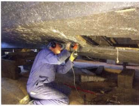
Start van de werkzaamheden afgelopen winter. Henry van de Wal zaagt aan stuurboord voorzichtig vlakdelen uit
