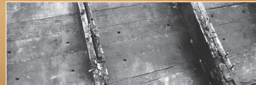
Fig. 17 Gaten in de vlakdelen van de bun.
