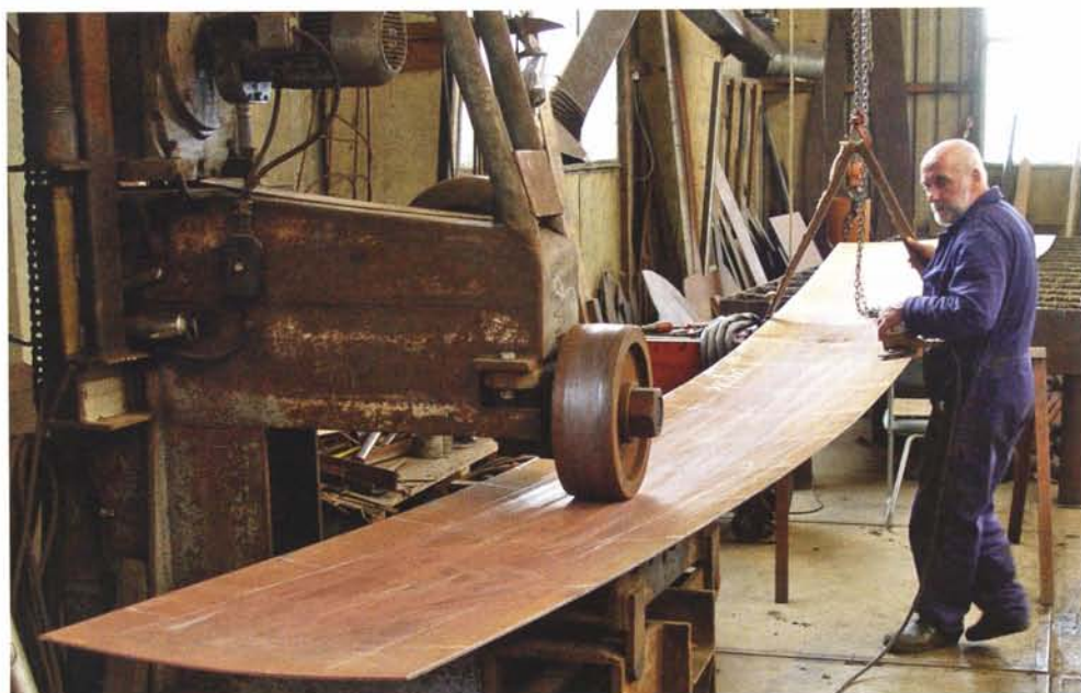
Walsen van de gangen in de rollenbank. Onder: Controleren van de ronding tijdens het walsen.
