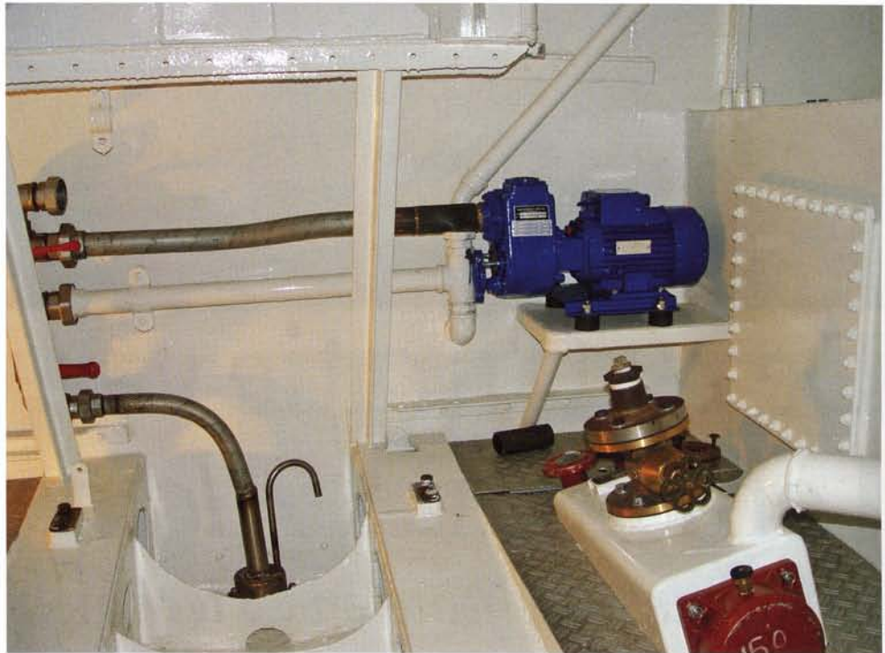
Lenspomp, beunkoeler, statische olie-afscheider en mangat van geïntegreerde brandstoftank.
