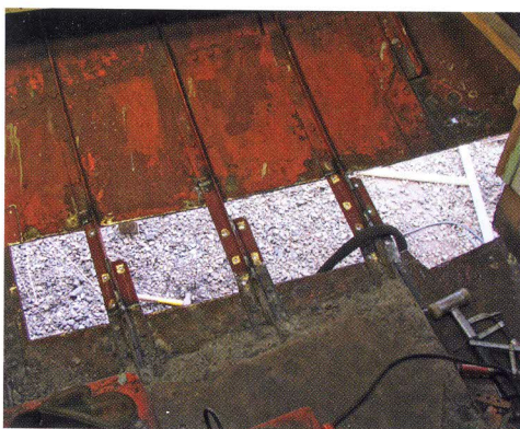
Doorgeroest op de rand van de betonballast
