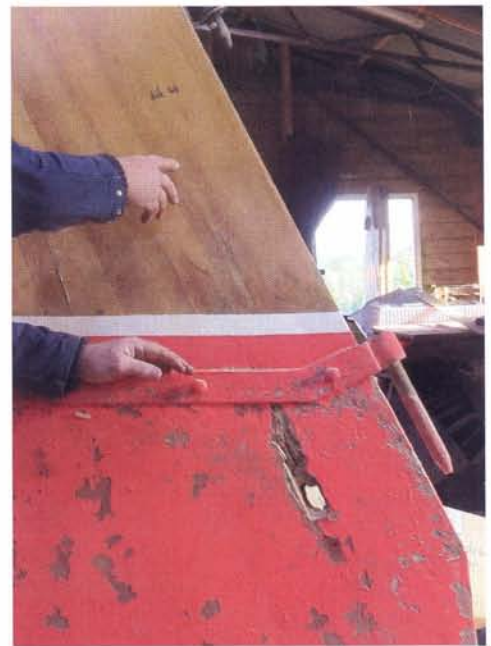
Wim Mendelts wijst op de aangetaste naden. Duidelijk zichtbaar is het gat onder de waterlijn
